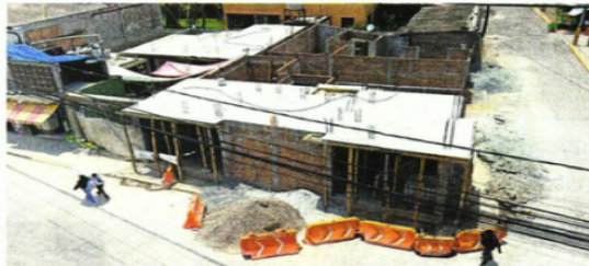
Algunas de las viviendas que van a ser reparadas continúan en obra negra, a la espera de que lleguen los recursos para los trabajos.
