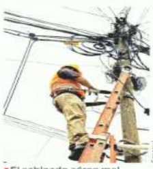
El cableado aéreo mal instalado pone en riesgo a los peatones.
