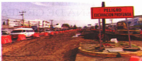
En el bulevar Cuauhtémoc, en la entrada principal al municipio en su entronque con la Méxco-Cuautla, se iniciaron excavaciones profundas.
