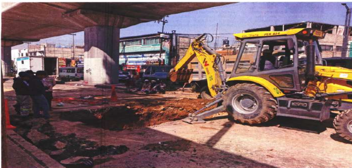
El socavón se registró sobre avenida Tláhuac, entre las estaciones Nopalera y Zapotitlán de la Línea 12 del Metro. El Sacmex prevé terminar la reparación hoy.
