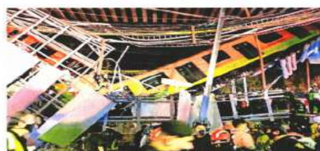
El 3 de mayo de 2021 una de las trabas de concreto de la Línea 12 del Metro colapsó entre las estaciones Olivos y Tezonco.
