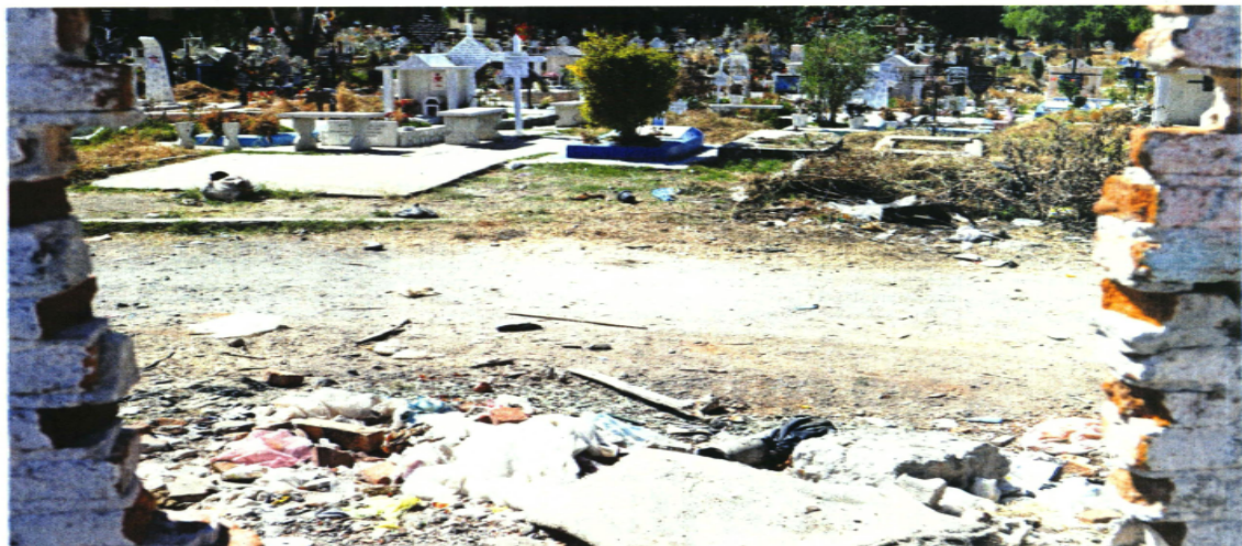
En San Lorenzo Tezonco es notorio un pedazo de barda derribada que facilita el acceso al panteón. También arrojan basura, entre otros objetos.
