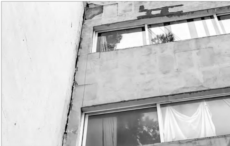
▲ Debido a los microsismos recientes en la ciudad, un inmueble ubicado en avenida San Antonio, colonia Ciudad de los Deportes, en la alcaldía Benito Juárez, sufrió agrietamiento y desprendimiento leve de acabados. Foto Alfredo Domínguez
