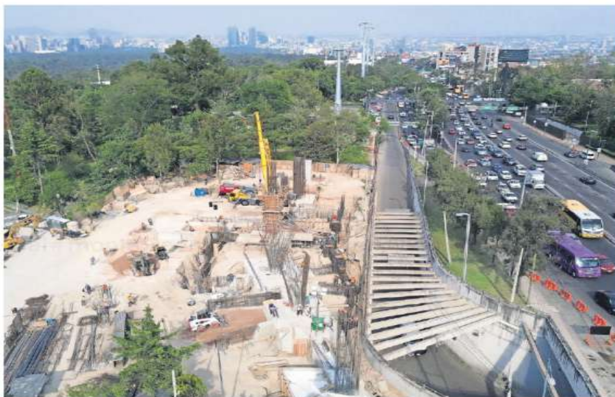
La tercera línea del Cablebús irá de Los Pinos a Vasco de Quiroga y conectará las cuatro secciones del Bosque de Chapultepec. Se prevé que la obra civil se concluya en diciembre próximo.
