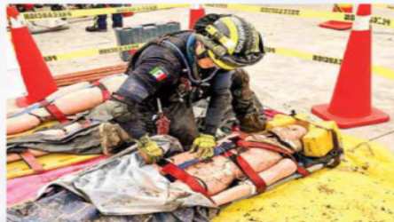
Se realizó un ejercicio de 17 horas continuas como parte de la capacitación en rescate de estructuras colapsadas.
