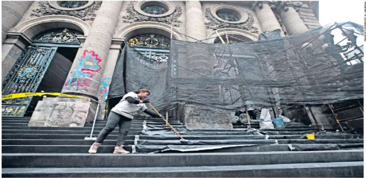
Un equipo de restauradores avanza en los trabajos del Congreso de la Ciudad de México, luego de que en febrero grupos trans vandalizaron la fachada como protesta a una iniciativa de ley. La meta es concluir la reparación antes de septiembre, cuando arranca el periodo ordinario.
