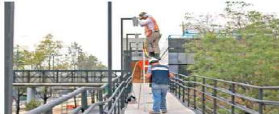
EL UNIVERSAL pudo observar que en los alrededores de las estaciones faltan pequeños detalles en los puentes peatonales.
