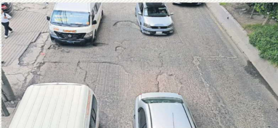
A cinco meses de que se anunció el programa de bacheo, aún se observa deterioro en la carpeta asfáltica de los carriles laterales y centrales de Periférico Norte.
