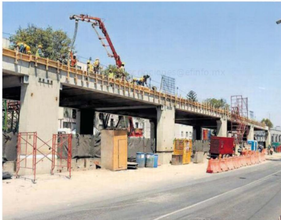
Avance de la Calzada Elevada sobre Tlalpan obra que construye el Gobierno de la CDMX por la Copa Mundial
