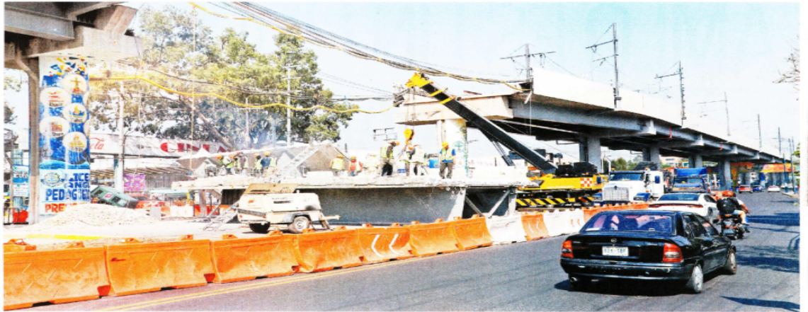
A casi un mes del colapso de una trabe de la Línea 12 del Metro, que provocó la muerte de 26 personas y que el servicio esté suspendido, trabajadores retiraron la estructura dañada del tramo elevado, la cual será llevada a talleres de Tláhuac.
