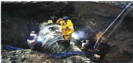
Trabajadores del Sistema arrancaron con el atomillado de las piezas para sellar el desperfecto.
