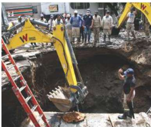
TRABAJADORES del Gobierno capitalino reparan la ruptura en una tubería de 48 pulgadas, la cual provocó una fuga de agua durante horas, que dio origen a un socavón.
