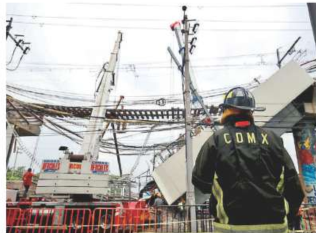
A las ocho de la mañana de este martes, Inician los trabajos para mantener libre la zona para la fase de desmontaje y retiro de estructuras. Especial
