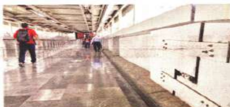
Las separaciones de los pasillos fueron reparadas sólo con placas y tornillos.
