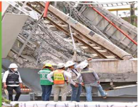
Una treintena de técnicos recorrieron ayer la zona cero, recogieron material y tomaron imágenes con ayuda de un dron y una grúa.
