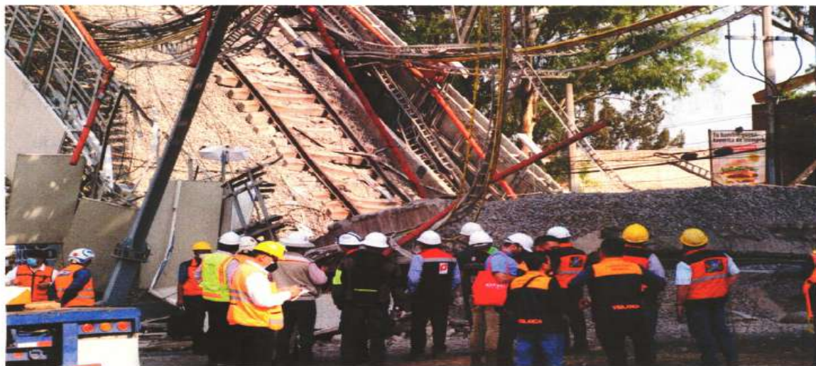
En el área del desplome de la Línea 12 del Metro, en la estación Olivos, autoridades continúan con los trabajos de revisión de la zona.
