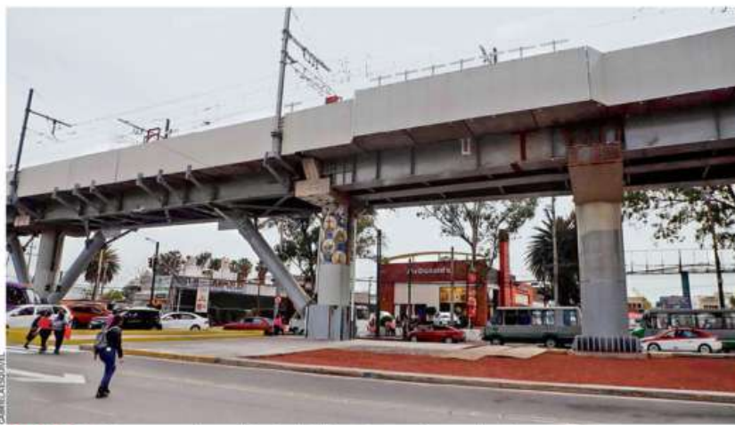
MEMORIA. En el tramo que se derrumbó entre los Olivos y Tezonco, fueron colocadas en una de las columnas cruces para recordar la tragedia.
