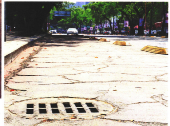
Algunas ciclovías tienen daños provocados por camiones y motos; la presencia de coladeras que pueden provocar caídas, señalan usuarios.
