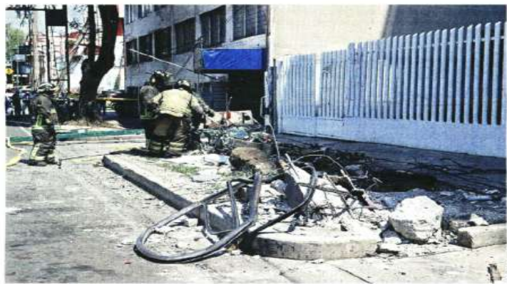
Debido a que resultaron afectadas líneas de media tensión, personal de CFE cortó la energía.
